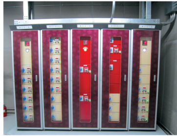
소방용 MCC 패널
