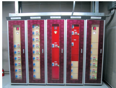
소방용 MCC 판넬
